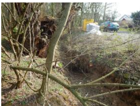
koryta vodoteče na okraji intravilánu obce - eroze břehů i dna koryta
