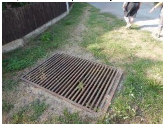
nekapacitní vtokový objekt v místě soutoku obou drah soustředěného odtoku (DSO)
