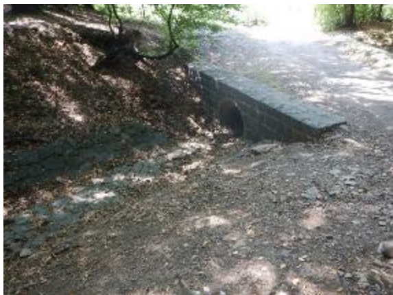
lokalita zaneseného propustku a směr povodňového odtoku po komunikaci
