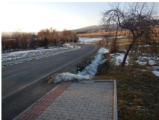
pohled na místo kritického bodu (výtok se široké údolnice pod silnicí)
