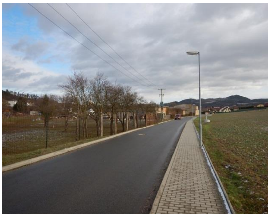
při vydatnějších deštích je komunikace zanášena erozními splachy
