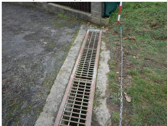
vtok do systému dešťové kanalizace
