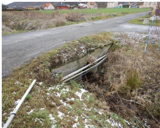
snížená průtočnost na povodňové straně propustku
