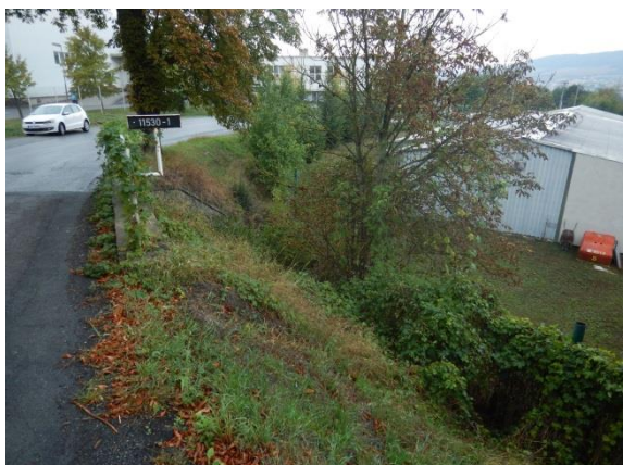
silnice Na Ratince - kritický bod
