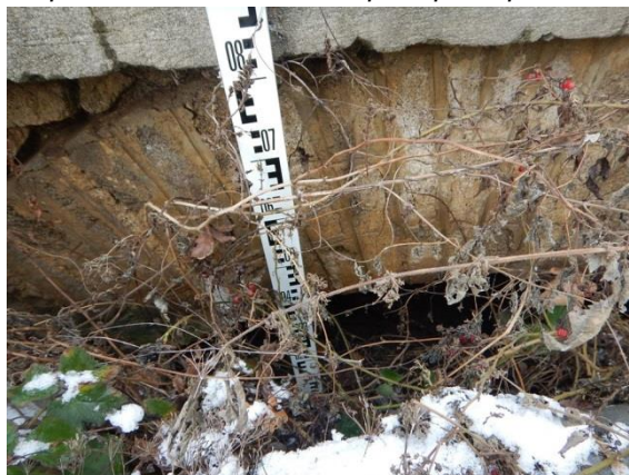
detail zanešeného propustku
