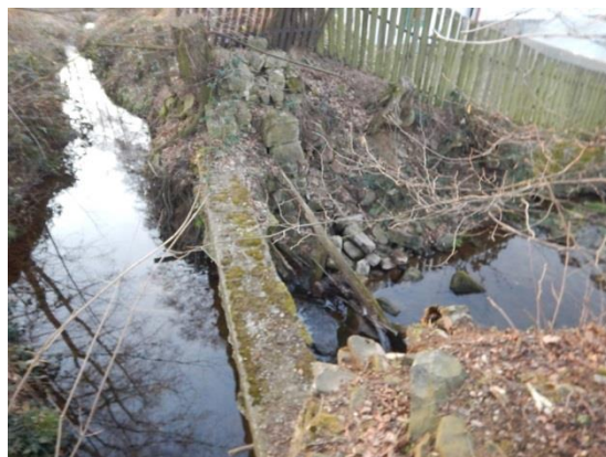
kritický bod - rozpadající se objekt
