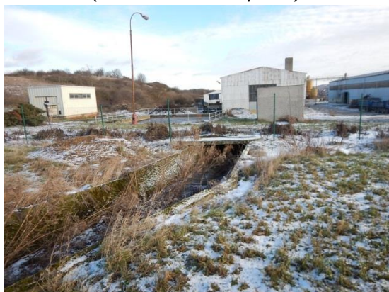
KB - voda ze svodnice vtéká do zatrubnění v areálu zemědělského družstva
