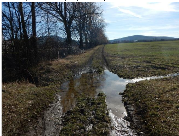
podmáčená cesta nad propustkem
