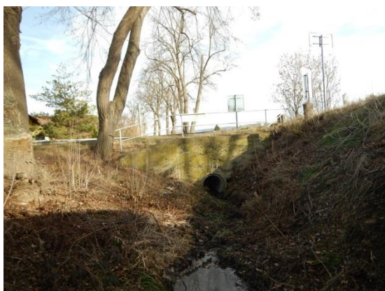
zatrubnění odtoku (spojený odtok ze dvou svodnic) pod hlavní silnicí
