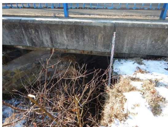
pod nádrží potok podtéká hlavní silnici
