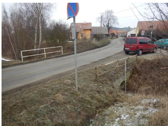
propustek DN 800 pod kritickým bodem
