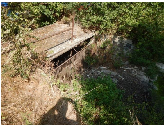
nevyhovující bezpečnostní přeliv
