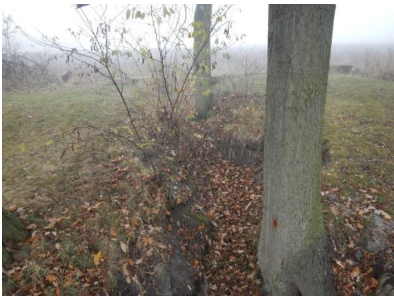
koryto pod přelivem (bez opevnění, snížení průtočného profilu vzrostlými stromy)
