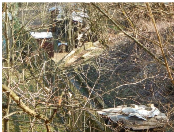
pohled do strže pod cestou (patrný žlab pro bezpečné převedení vody podél zástavby)
