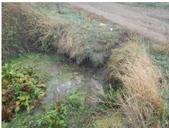
propustek 2x DN 800, zanesený
