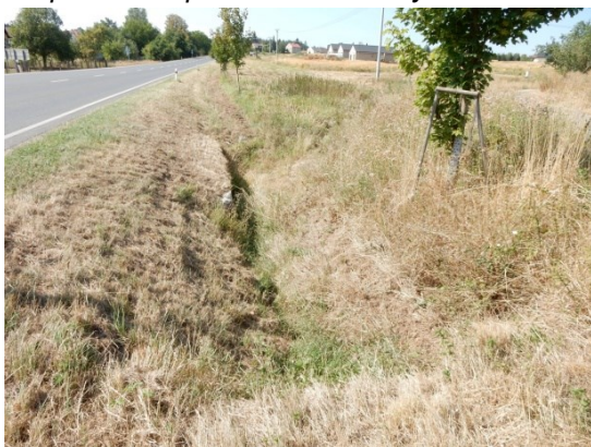
propustek v místě kritického bodu
