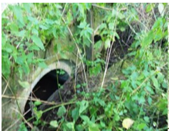
Propustek v místě kritického bodu
