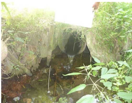
Propustek v místě kritického bodu
