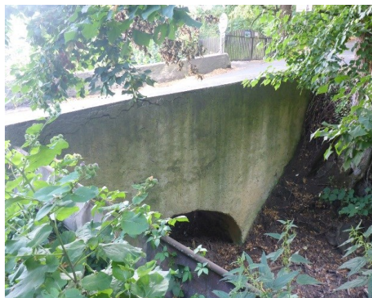
propustek v místě kritického bodu
