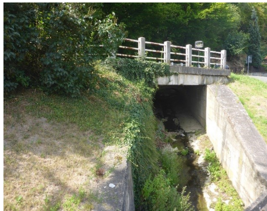
propustek v místě kritického bodu
