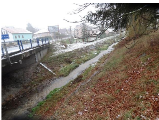
Pohled z mostu na severu obce proti proudu, na pravém břehu ohrožená zástavba
