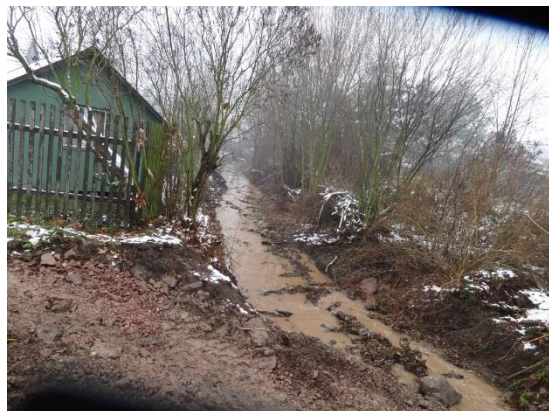
Koryto toku před opravou, pohled po proudu (listopad 2018)
