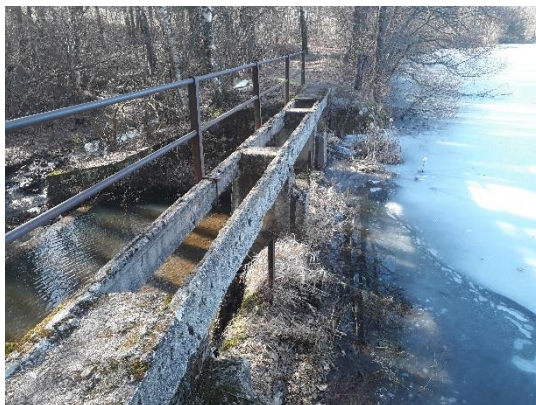
Obr. 38: stávající nevyhovující stav bezpečnostního přelivu rybníka Heřman
