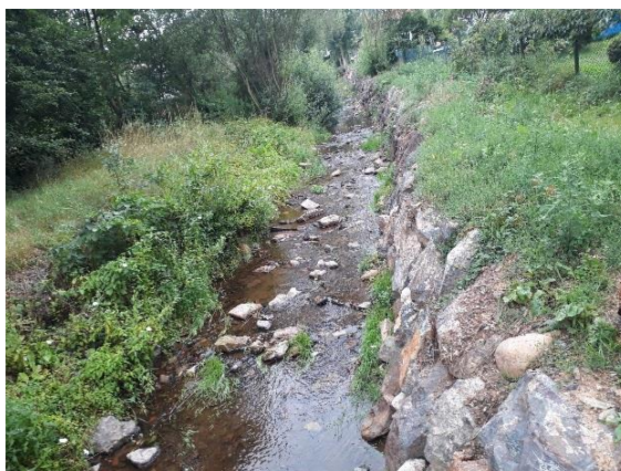
Obr. 54: pohled proti proudu, stávající koryto s provizorní opravou (v tomto místě levého břehu)
