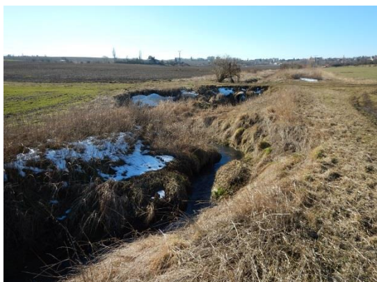
Počátek eroze pod cestním propustkem
