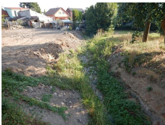
Navážka a chybějící opevnění koryta
