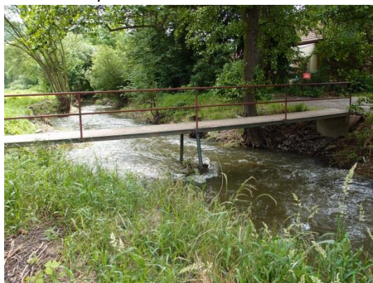
Problémová lávka u objektu
